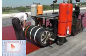
Auf der Waldschlösschenbrücke wird jetzt die Asphaltdecke der Fahrbahn aufgetragen. Foto: SachsenGAST
