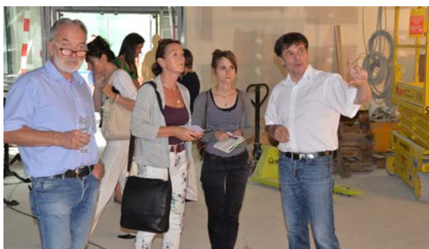
Beim Pressebesuch auf der Baustelle gibt Armin Proft (r.) Erläuterungen links Heiner Thomas.
