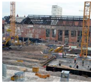
Blick auf die Baustelle des ehemaligen Kraftwerkes Mitte, wo die Kräne von aktiver Tätigkeit zeugen, dass hier bald ein Kulturzentrum entsteht. Foto: SachsenGAST
